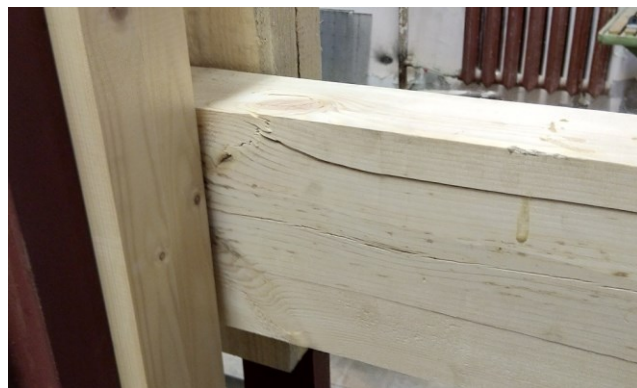
Рис. 8. Разрушение растянутой зоны балки серии БД
