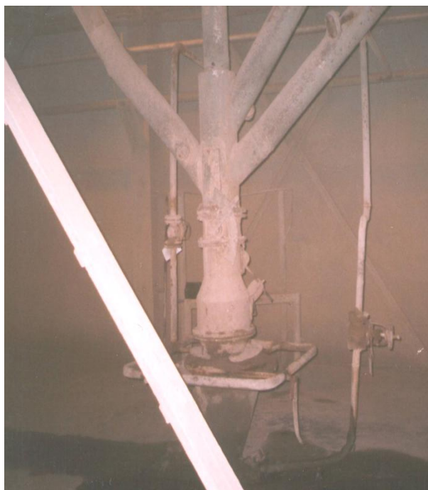
Рис. 3. Присоединение четырех течек от бункеров батарейного циклона к устройству для централизованного сброса золы
