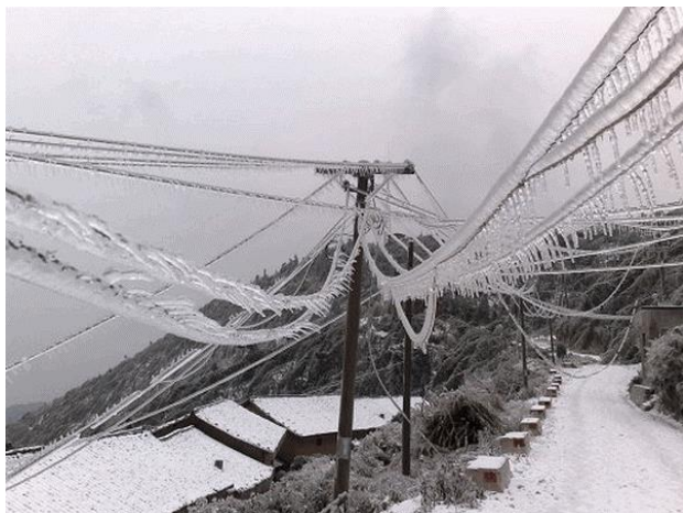
Рис. 1. Гололёд на проводах ЛЭП
