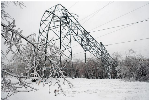
Рис. 2. Разрушение опор при гололёде
