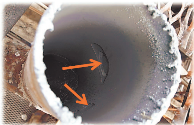
Рис. 1. Не обнаруженные традиционными методами НК дефекты типа «потери сечения» на трубопроводе DN 200
