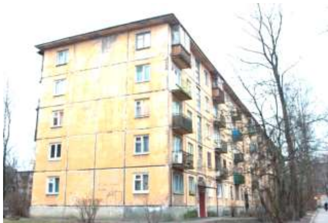
Рис. 1. Повреждения фасада многоквартирного дома
