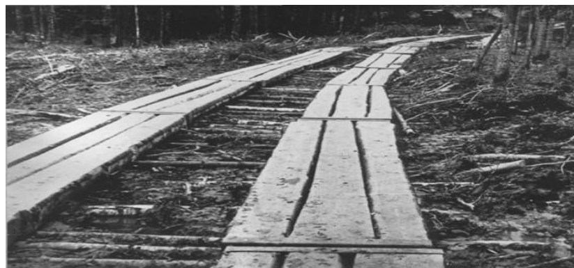
Рис. 2. Дороги с колейным покрытием из деревянных щитов
